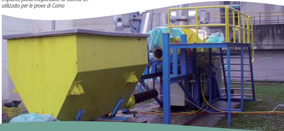
Impianto pilota trasportabile di Solenia SA utilizzato per le prove di Como
